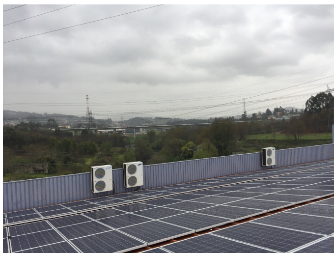
Crispim Abreu - UPAC de 375KWp
